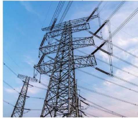
Les câbles électriques du réseau dissipent de l'énergie thermique par effet Joule.
